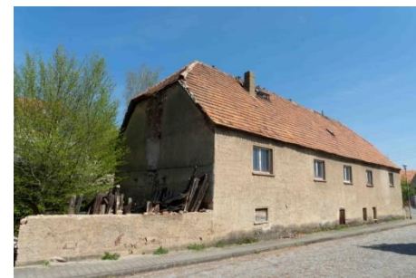
(3) sanierungsbedürftiges Gebäude an der Dorfstraße
